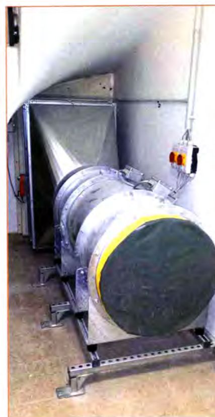
Abb. 2: Redundante Zuluftventilatoren (mit Abdeckung gegen Baustaub)
